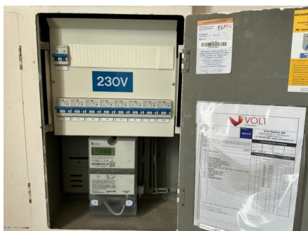
Automatsikringer i sikringsskap plassert i gang/fellesareal.
