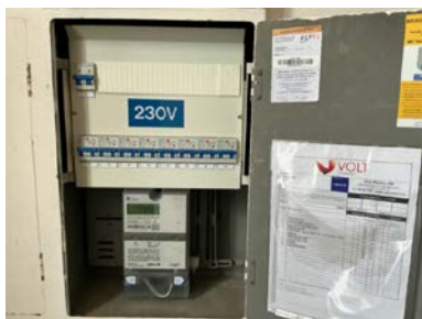
Automatsikringer i sikringsskap plassert i gang/fellesareal.
