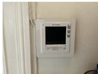
Dørcalling med monitor er plassert i gang.
