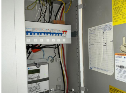
Automatsikringer i sikringskap plassert i gang/fellesareal.
