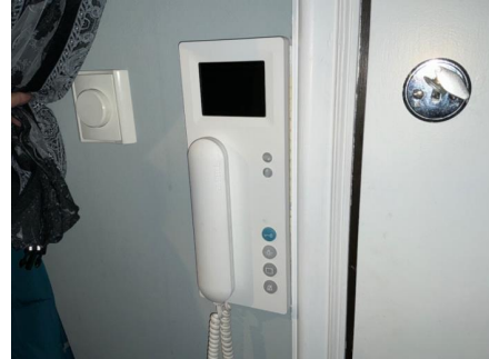
Dørcalling med monitor som er plassert i entre.
