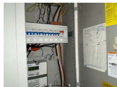
Automatsikringer i sikringskap plassert i gang/fellesareal.
