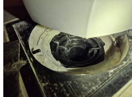
Sluk under varmtvannsbereder.
