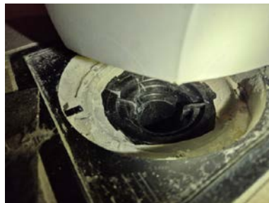
Sluk under varmtvannsbereder.
