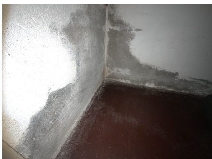
Synlig saltutslag i ytre hjørne i bod.
