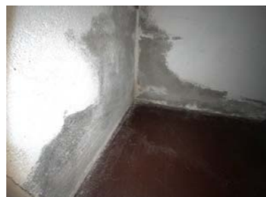
Synlig saltutslag i ytre hjørne i bod.
