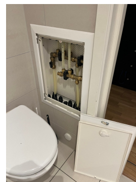
Fordelerskap med stoppekran, funksjonstestet ok.
