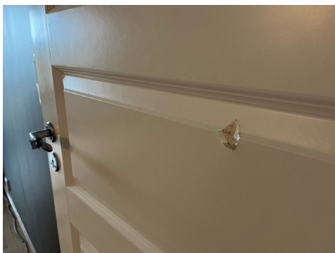
Skade i dørblad.
