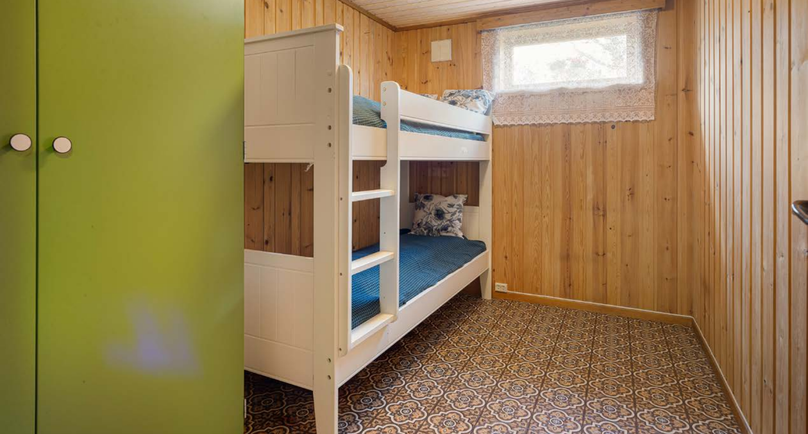
Innredet rom. Rommet er ikke godkjent som soverom/rom for varig opphold
