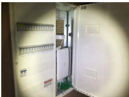
Innmat i sikringskap
