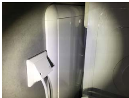
Fordelerskap for rør-i-rør
