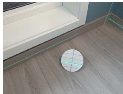
Måling av skjevhet/retningsavvik på gulv i stue
