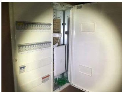
Innmat i sikringsskap
