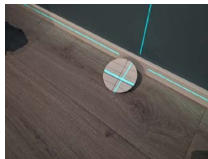
Måling av skjevhet/retningsavvik på gulv i soverom
