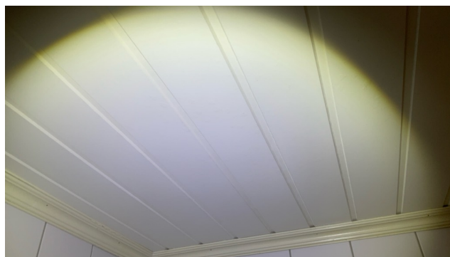
Svelleskader i himlingspanel.
