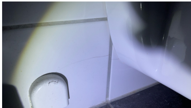
Sprekker i veggfliser ved toalettet.
