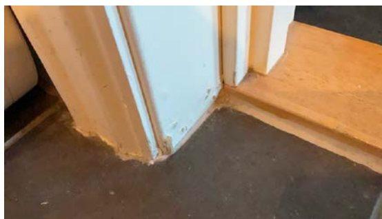
Svelleskader i utforinger på døren.
