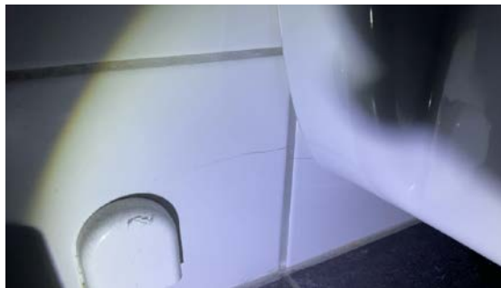
Sprekker i veggfliser ved toalettet.
