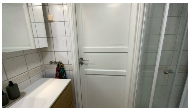
Baderomsdør i 2. etasje henger i karmen.
