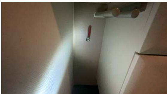
Hovedstoppekran er plassert ved siden av servant på badetrom.
