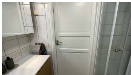
Baderomsdør i 2. etasje henger i karmen.
