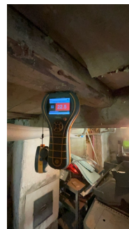
Høy fukt i trebjelkelag. Dette (22,5 vektprosent fukt) regnes som meget fuktig trevirke. Det bør være under 17 vektprosent fukt.
