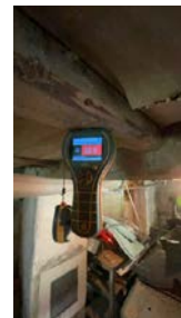
Høy fukt i trebjelkelag. Dette (22,5 vektprosent fukt) regnes som meget fuktig trevirke. Det bør være under 17 vektprosent fukt.
