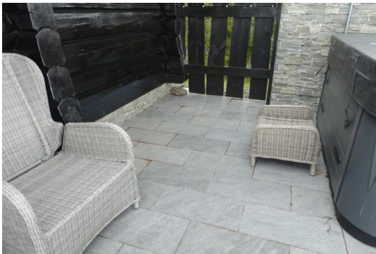
Påvist at stort samtlige skiferfliser er løse/ligger med bom og utilstrekkelig liminnfesting. Skiferfliser må beregnes relagt.
