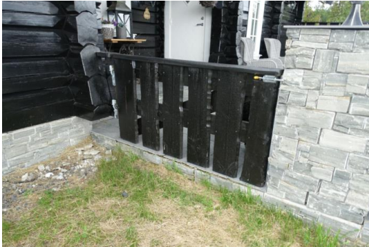
Påvist skader i trinnløsningen.
