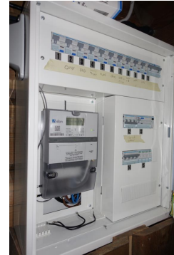
Sikringsskap med noe enklere kursfortegnelse.
