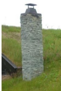
Pipen over tak - merk at avdekningen ikke er ført utenfor utv. forblending jfrr. event. vanninntrekk og frostskafer av forblendingen.
