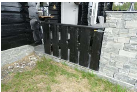
Påvist skader i trinnløsningen.
