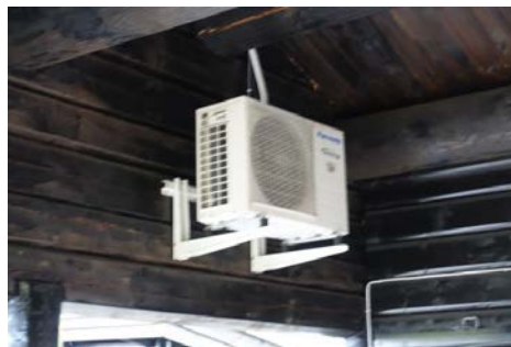
Utv. aggregatdel til luft til luft varmepumpen.
