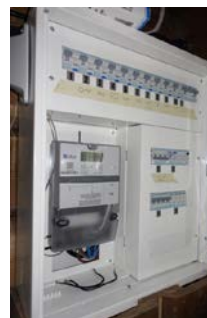
Sikringsskap med noe enklere kursfortegnelse.
