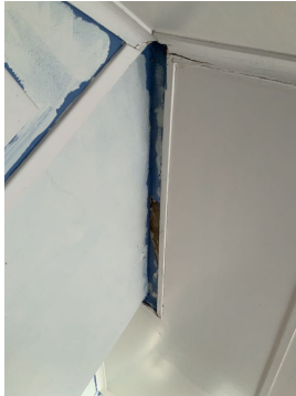
Overflater ved pipe i innredet rom
