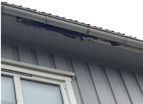
Skade på takutstikk
