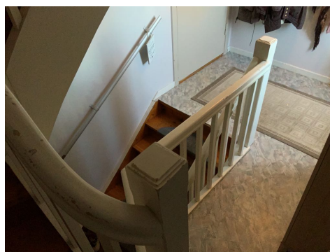
Rekkverk i 2.etasje er lavt
