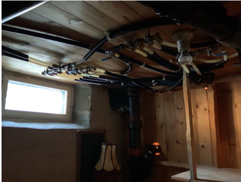
Rørfordeling i kjeller.
