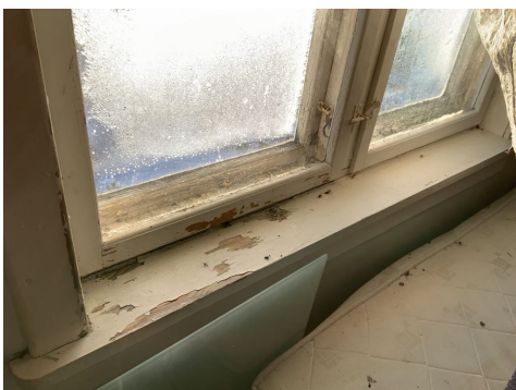
Vindu på loft, råteskader.
