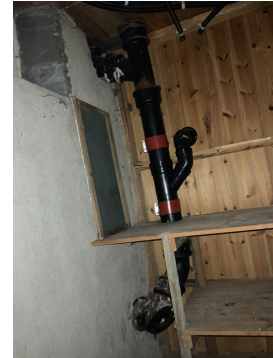
Soilrør/støpejern innvendig og delvis ut.
