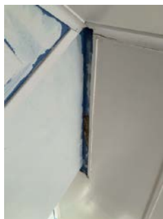
Overflater ved pipe i innredet rom
