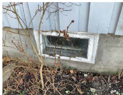
Vindu i kjeller råteskader
