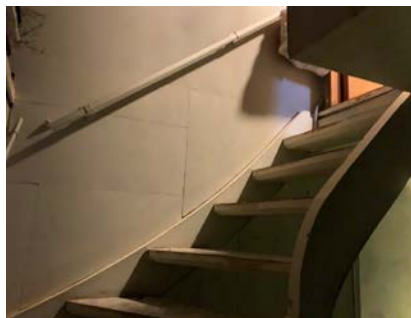
Trapp til kjeller har ikke rekkverk, kun håndløper på vegg.
