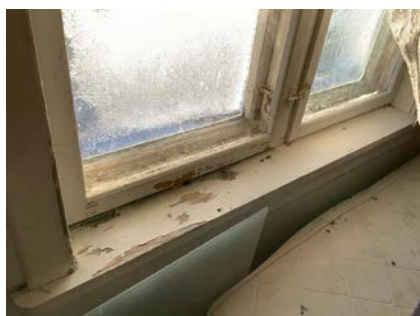
Vindu på loft, råteskader.
