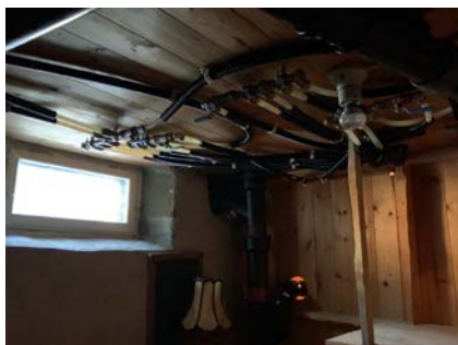
Rørfordeling i kjeller.
