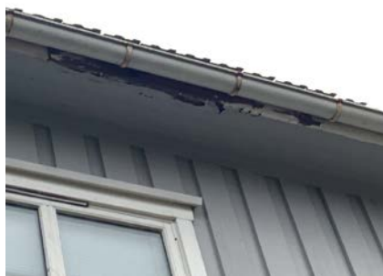
Skade på takutstikk
