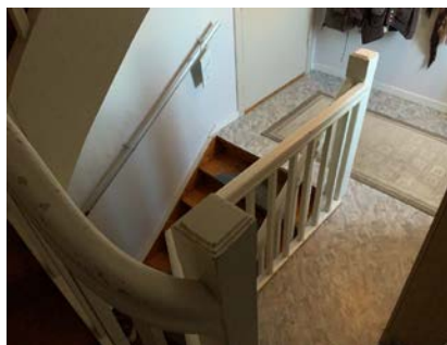
Rekkverk i 2.etasje er lavt
