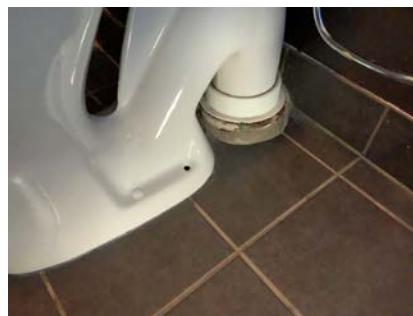
Soilrør fra toalett
