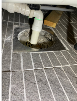
Sluk uten tilgang for inspeksjon og rengjøring.
