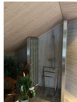
Dusj med skråtak uten membran på skråtak.
