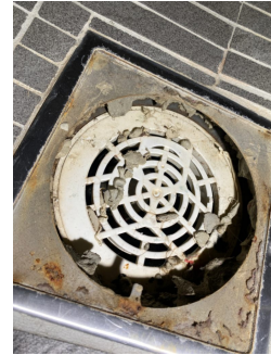
Sluk uten tilgang for inspeksjon og rengjøring.
