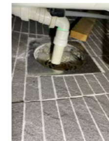
Sluk uten tilgang for inspeksjon og rengjøring.
