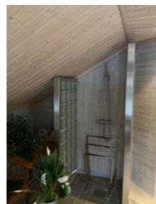
Dusj med skråtak uten membran på skråtak.
