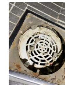
Sluk uten tilgang for inspeksjon og rengjøring.
