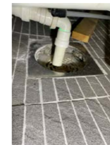
Sluk uten tilgang for inspeksjon og rengjøring.
