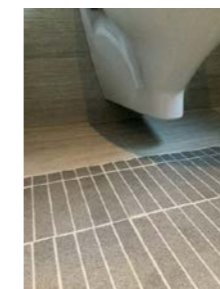
Det er ikke påvist tilfredsstillende løsning for å synliggjøre lekkasje fra innebygget systerne.
