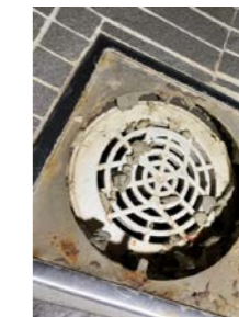
Sluk uten tilgang for inspeksjon og rengjøring.
