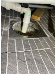
Sluk uten tilgang for inspeksjon og rengjøring.
