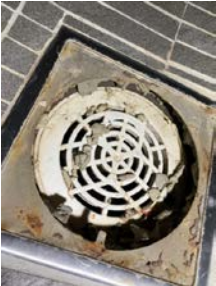
Sluk uten tilgang for inspeksjon og rengjøring.
