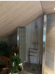
Dusj med skråtak uten membran på skråtak.
