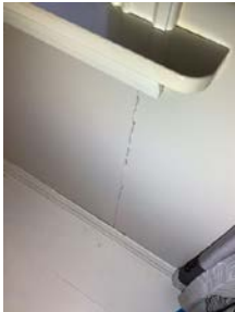
Eksempel på skader. Betydelig sprekker i plateskjøter.
