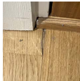
Skade på parkettgulv ved hovedytterdør.
