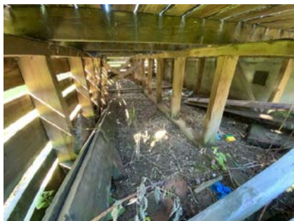
Utbedringer av fundamenter er påregnelig.
