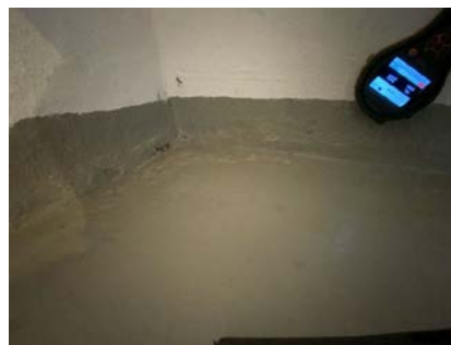
Indikert variable fuktverdier på nedre del av grunnmur.
