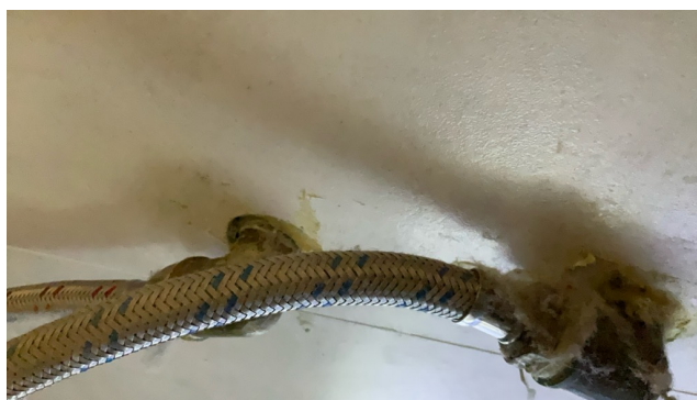
Utett fuge i rørgjennomføring.
