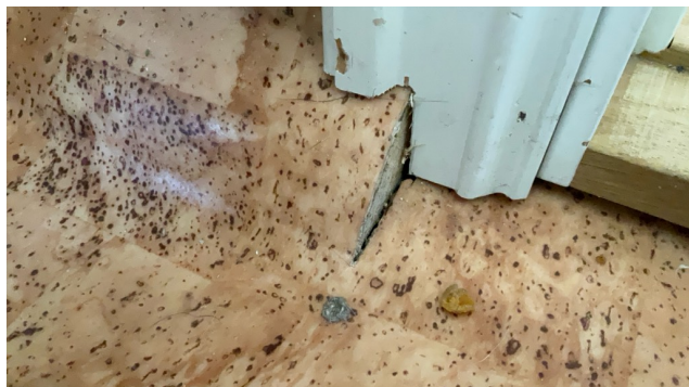
Utett gulvbelegg ved dør.
