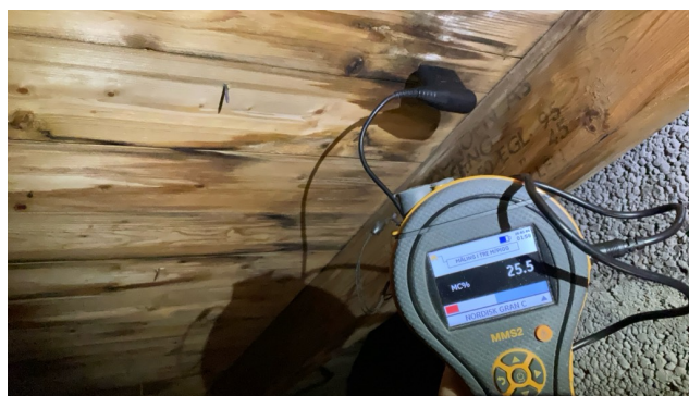
Høye fuktverdier målt i undertaket/takkonstruksjonen rundt pipen.
