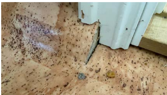
Utett gulvbelegg ved dør.
