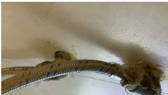
Utett fuge i rørgjennomføring.
