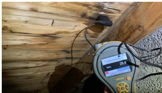
Høye fuktverdier målt i undertaket/takkonstruksjonen rundt pipen.
