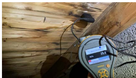
Høye fuktverdier målt i undertaket/takkonstruksjonen rundt pipen.
