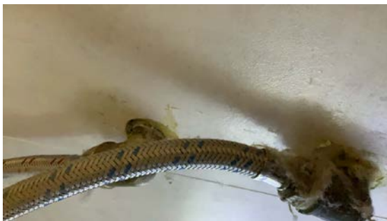
Utett fuge i rørgjennomføring.
