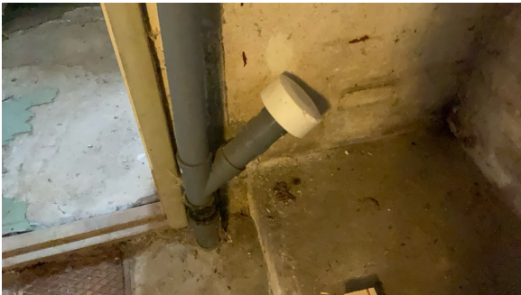
Vakumsventil på kloakk i kjeller.
