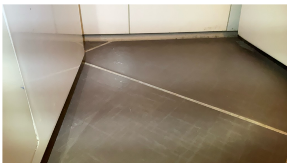
Manglende tetting i nedre kant av våtromsplater.
