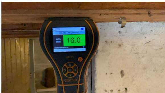
Fuktmåling i innvendig tak i kjeller.
