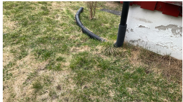
Takvann provisorisk ledet bort fra grunnmur.
