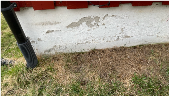
Løs maling på grunnmur.
