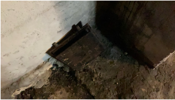
Skade på sotluke.
