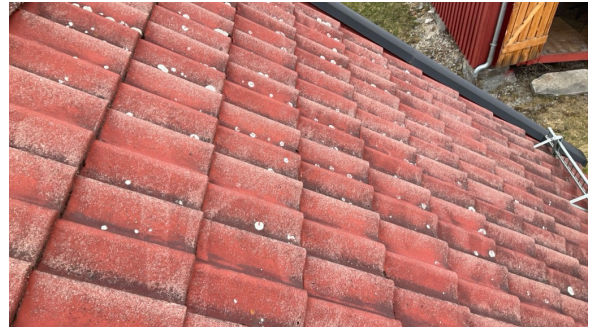
Tak er vasket, men ikke all mose er fjernet.
