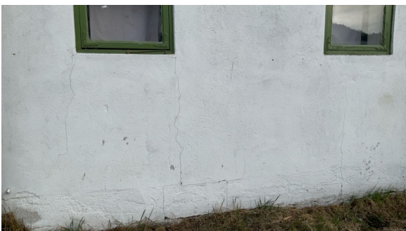
Noe riss i grunnmur.
