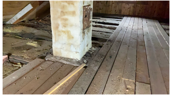
Manglende ikke brennbar plate under feieluke på loft.
