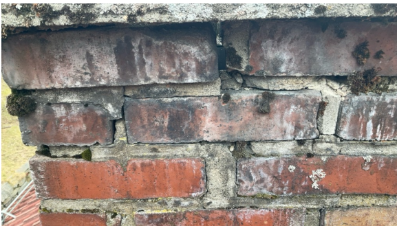
Sprekker i puss på pipe.
