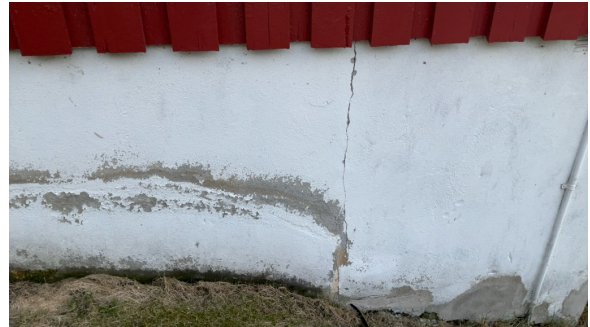
Fuktopptrekk og sprekk i grunnmur.
