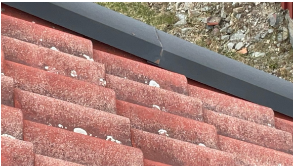
Noe rust på beslag på vindskier.
