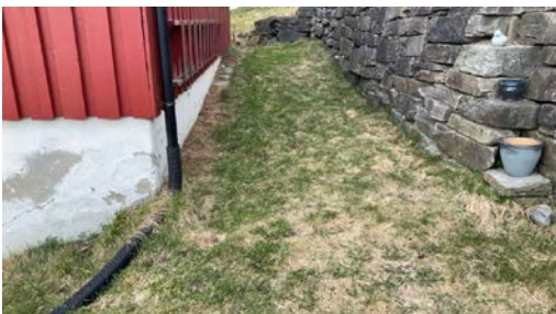
Fall på terreng mot grunnmur.
