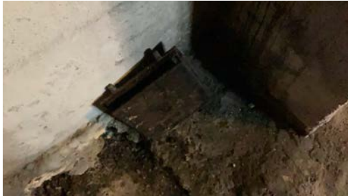
Skade på sotluke.
