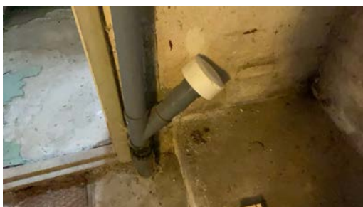
Vakumsventil på kloakk i kjeller.
