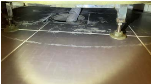
Sluk under dusjkabinett.
