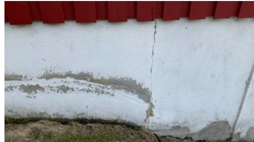
Fuktopptrekk og sprekk i grunnmur.
