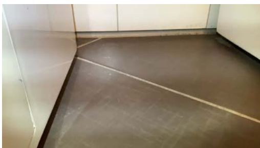
Manglende tetting i nedre kant av våtromsplater.
