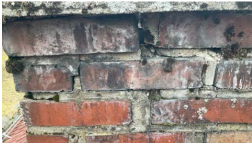
Sprekker i puss på pipe.
