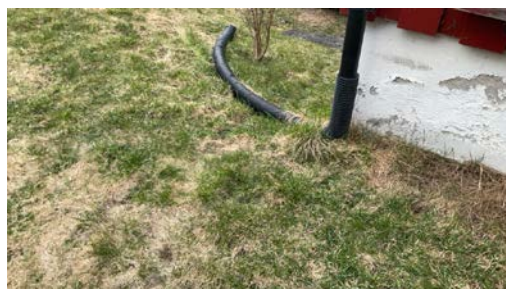
Takvann provisorisk ledet bort fra grunnmur.
