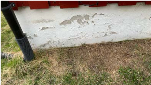
Løs maling på grunnmur.
