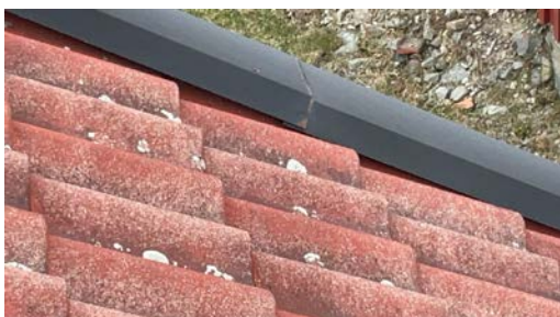
Noe rust på beslag på vindskier.
