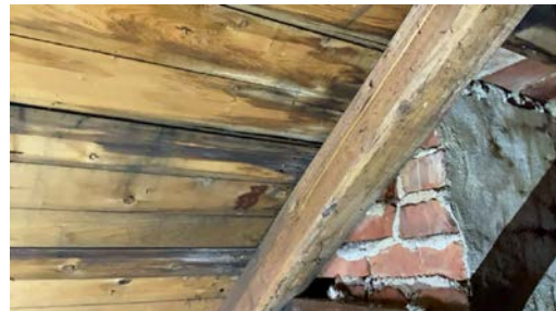
Misfarging av undertak ved pipe.
