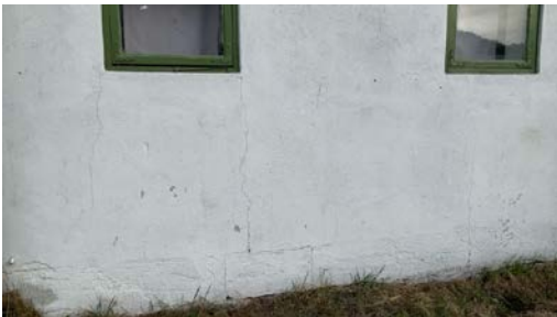
Noe riss i grunnmur.
