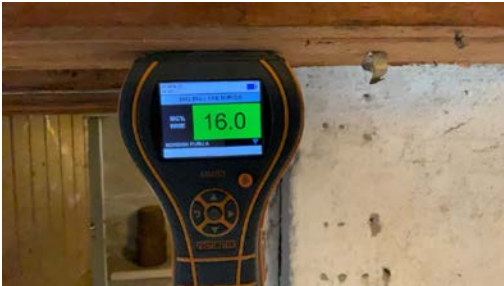
Fuktmåling i innvendig tak i kjeller.
