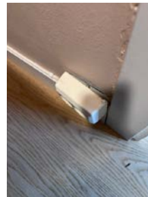
Løs stikkontakt på soverommet
