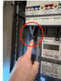
Manglende tetting/beskyttelse rundt kabler i gjennomføring i skap.
