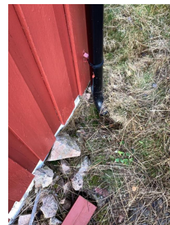
Manglende bortledning av vann fra nedløp.
