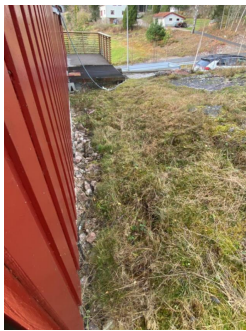
Skrånet terreng inn mot grunnmur.
