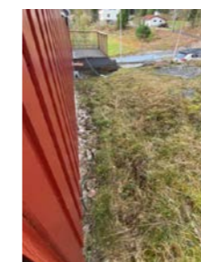
Skrånet terreng inn mot grunnmur.
