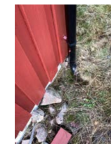
Manglende bortledning av vann fra nedløp.
