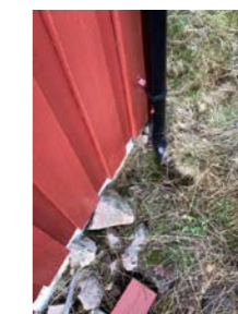
Manglende bortledning av vann fra nedløp.
