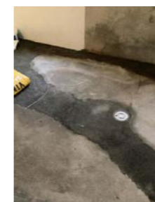
Gulvet i kjeller er pigget opp for å legge ny vannledning og avløp.
