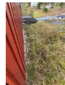
Skrånet terreng inn mot grunnmur.
