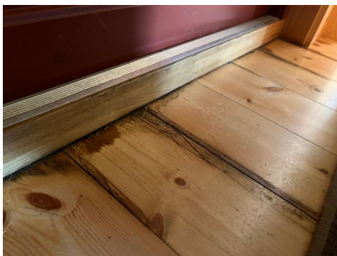
Fukt på gulv ved ytterdør
