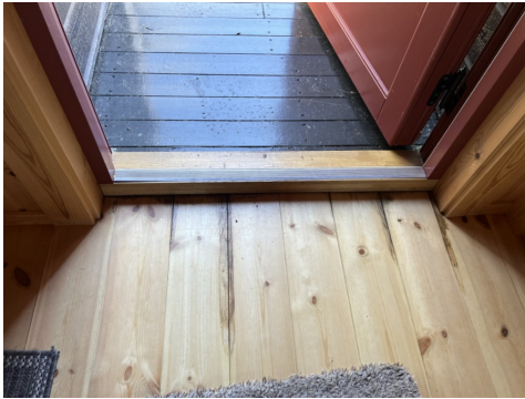
Fuktmerker på gulv/konstruksjon ved ytterdør
