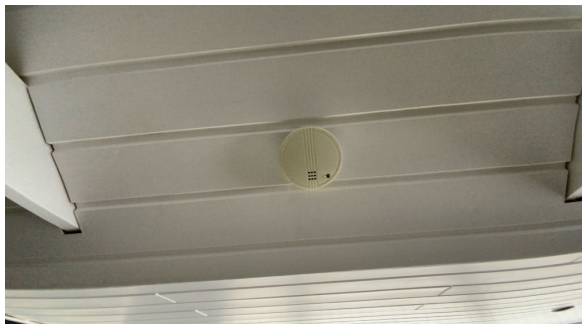
Røykvarsler i 2. Etasje.
