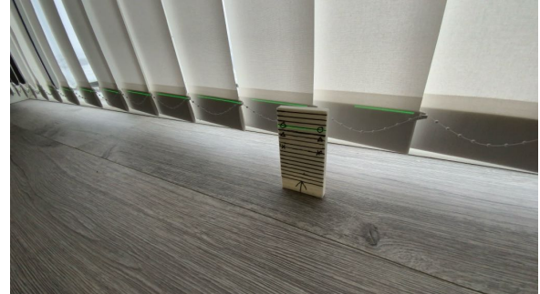
Høydeforskjell på ca 2,5 cm fra den ene siden av tv-stuen til den andre.
