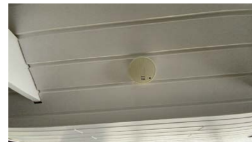
Røykvarsler i 2. Etasje.
