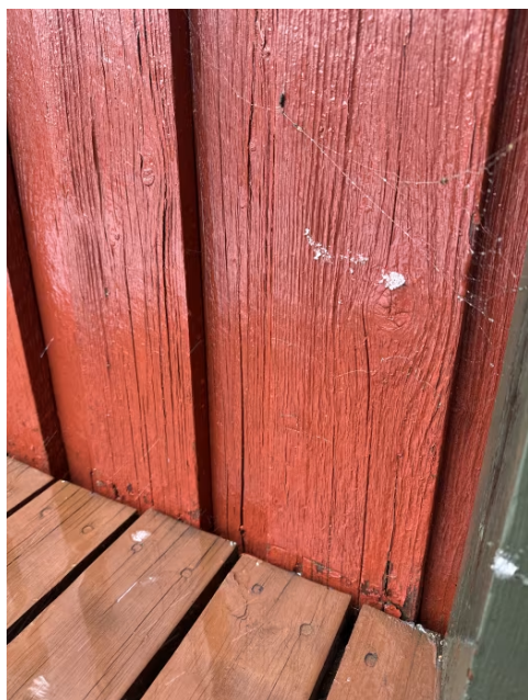
Det er værslitt/oppsprukket trevirke/trepaneler.
