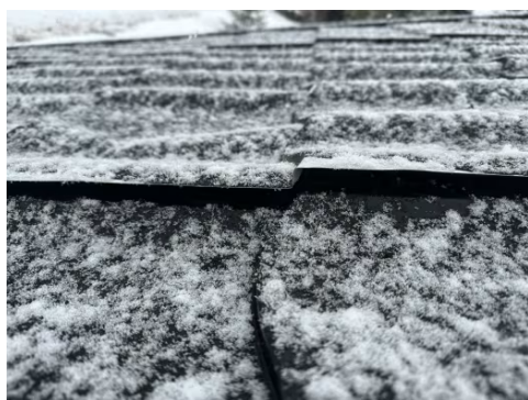
Det registreres enkelte glipper mellom plater.
