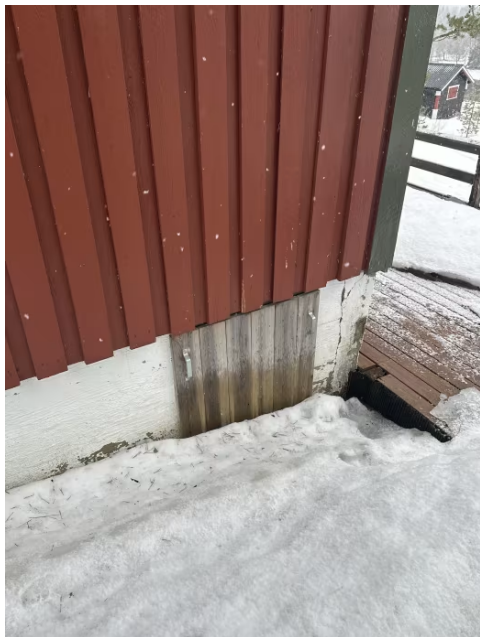
Luke til krypkjeller utvendig var fryst fast på befaringsdagen.
