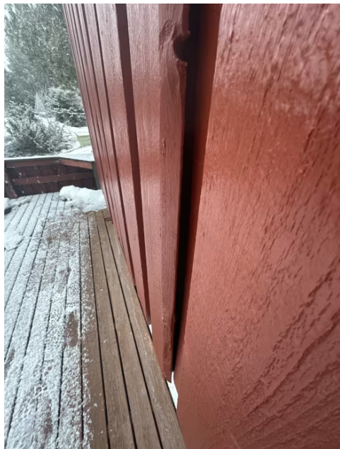
Det registreres mindre åpning imellom kledning ved terrasse.
