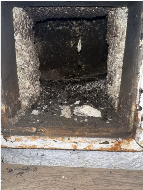
Viser sotluke bak innredning på kjøkkenet.
