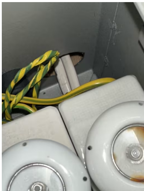
Det er hull/innføringer i inntak eller sikringssskap som ikke har nippelinnføringer
