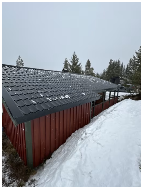
Deler av taket mangler renner og nedløp.
