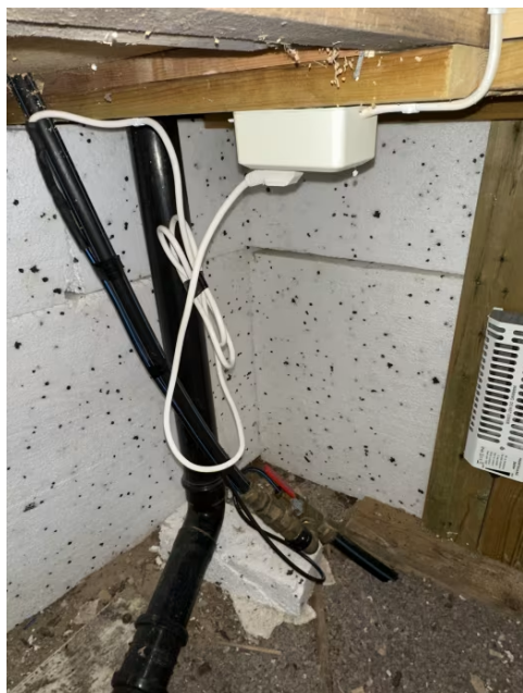
Viser vanninntak og hovedstoppekran.
