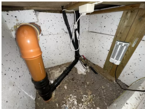
Viser avløpsrør i rom under terreng.
