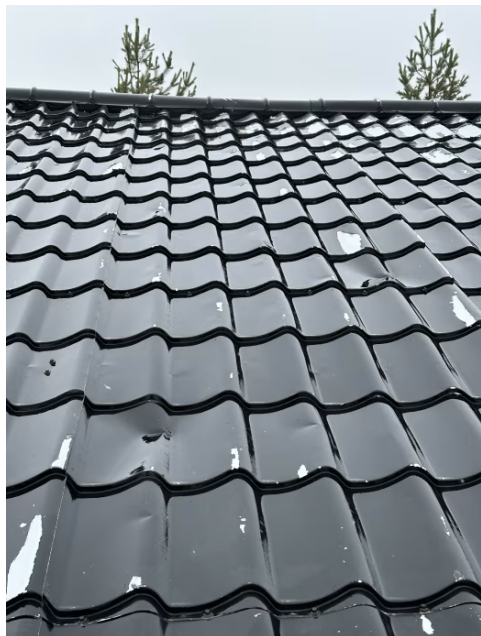
Det er bulker og nedbøy i takplater.
