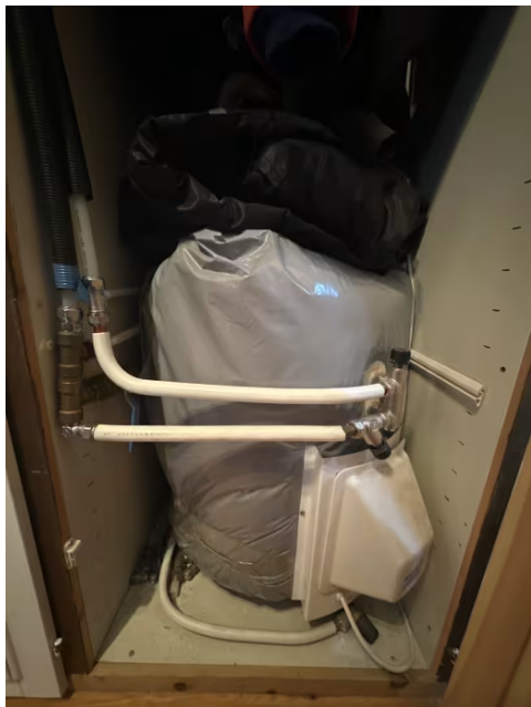
Viser bereder plassert i skap i gang.
