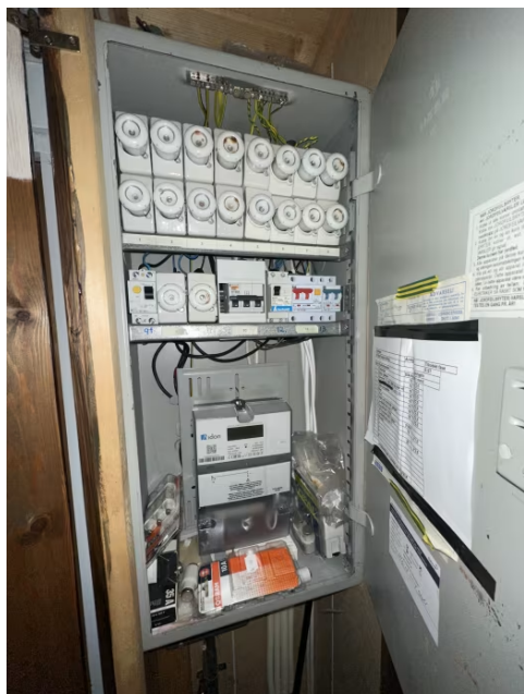
Viser sikringssskap plassert i gang.
