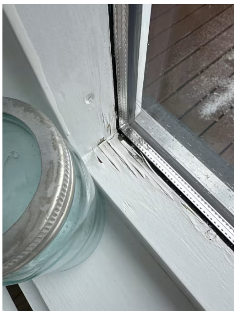
Det registreres misfarging på innvendige karmner og foringer, trolig pga. kondens.
