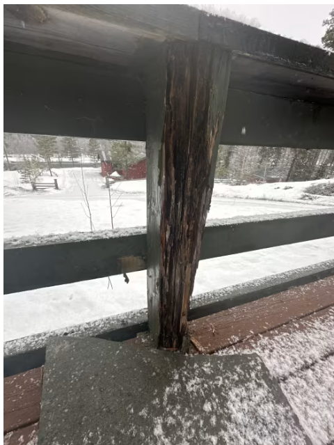
Rekkverk med råteskader.
