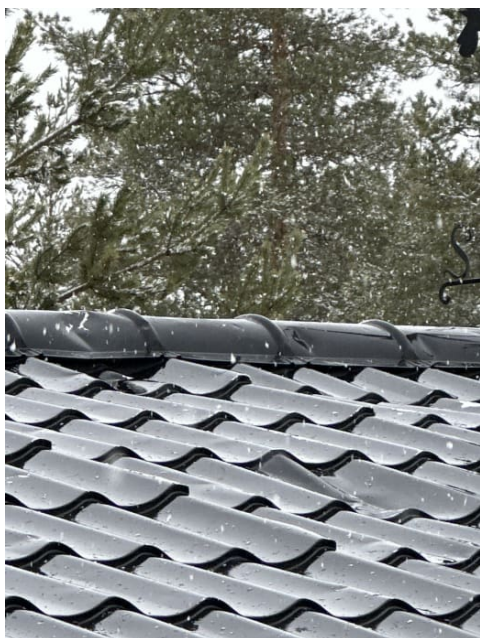
Det registreres bulker og nedbøy i takplater.
