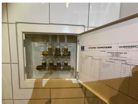
Vannrør med rør i rør system fra fordelerskap plassert på bad og frem til sanitærinstallasjoner på baderom.
