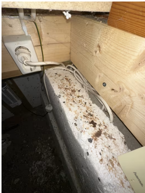
Det registreres muselort og musespist isolasjon i rom under terreng.
