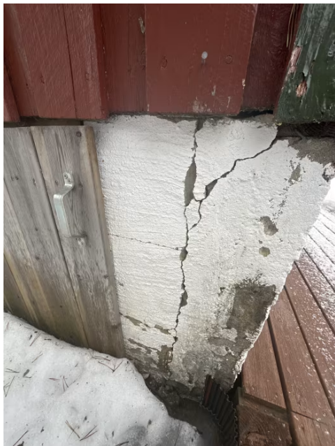
Viser sprekker i ringmur.
