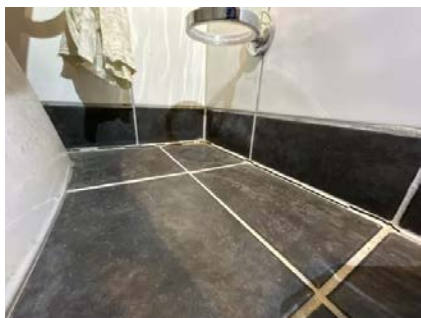
Det registreres glipper mellom gulv og veggfliser, med fare for skade i membran.
