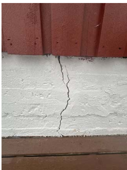
Viser sprekker i ringmur.
