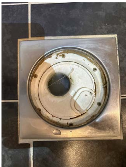
Viser sluk i dusjsonen.
