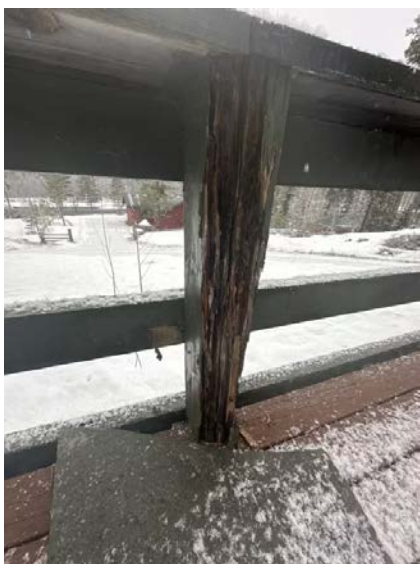
Rekkverk med råteskader.
