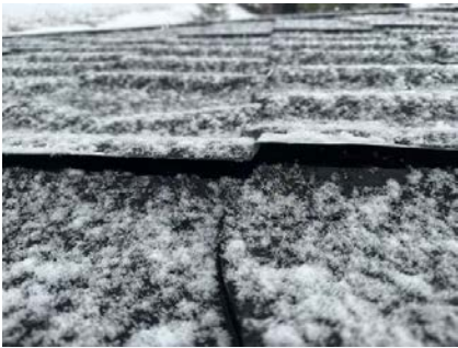
Det registreres enkelte glipper mellom plater.
