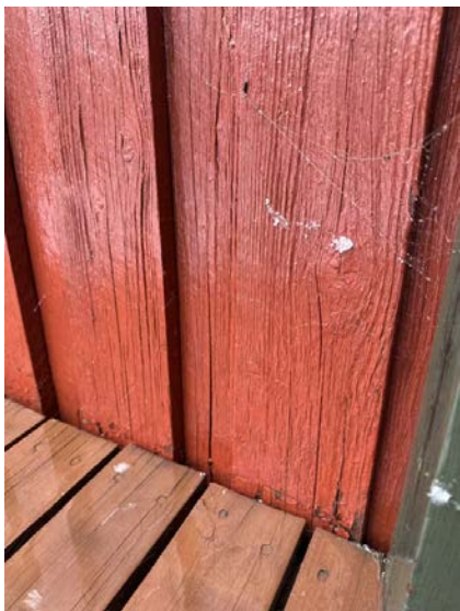
Det er værslitt/oppsprukket trevirke/trepaneler.
