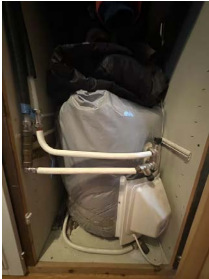
Viser bereder plassert i skap i gang.
