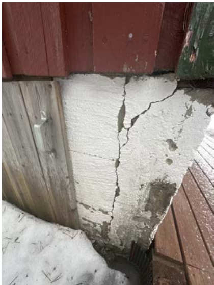
Viser sprekker i ringmur.
