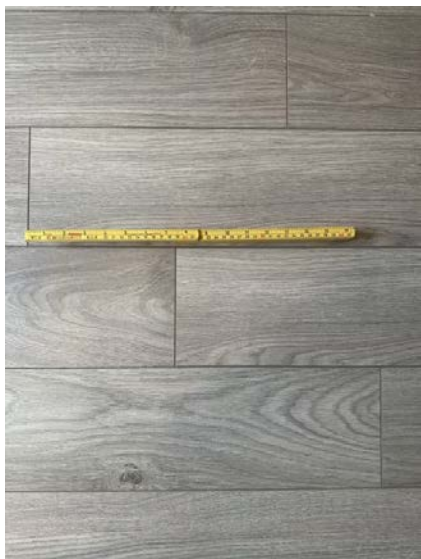
Det er påvist laminatgulv med mindre enn 30 cm mellom tverrskjøtene.
