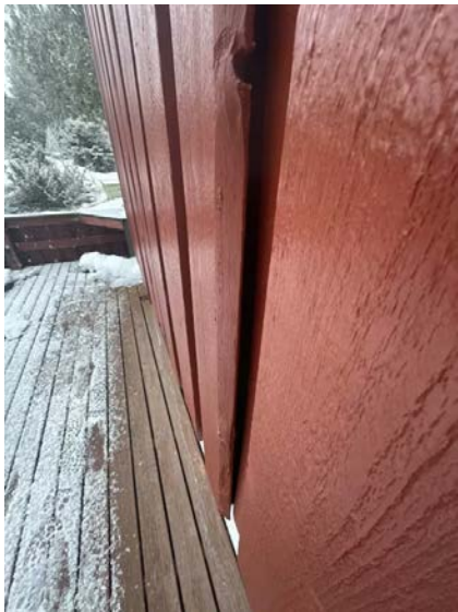
Det registreres mindre åpning mellom kledning ved terrasse.
