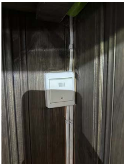
Byter for varmekabel i vannrør.
