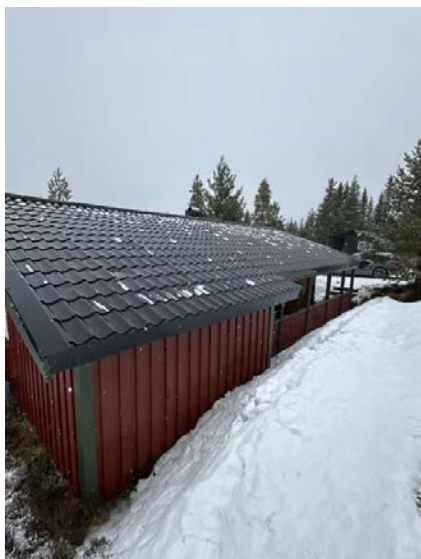
Deler av taket mangler renner og nedløp.
