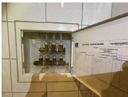
Vannrør med rør i rør system fra fordelerskap plassert på bad og frem til sanitærinstallasjoner på baderom.
