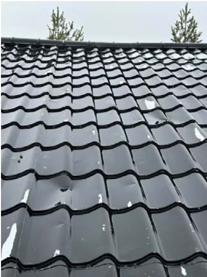
Det er bulker og nedbøy i takplater.
