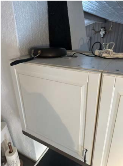
Avtrekk fra vifte er ikke ført ut mot fri.
