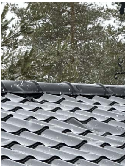
Det registreres bulker og nedbøy i takplater.
