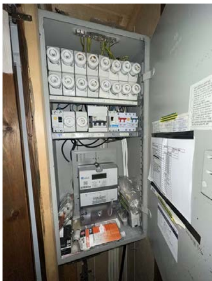
Viser sikringsskap plassert i gang.
