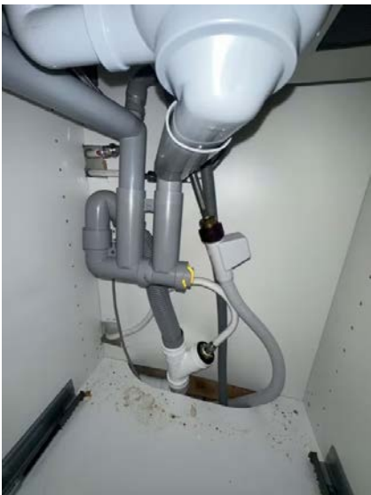
Viser vann og avløpsinnstallasjoner under kum
