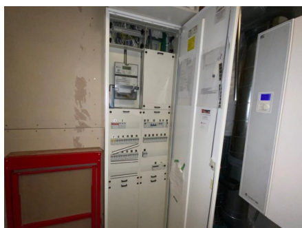
Automatsikringer i sikringskap plassert i teknisk rom.
