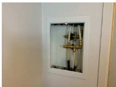
Vanntilførsel er ført til vannfordelerskap avsatt i soverom i plan 2.
