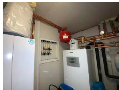
Vanntilførsel er ført til vannfordelerskap avsatt i teknisk rom.
