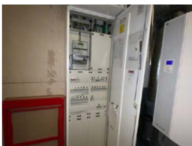
Automatsikringer i sikringsskap plassert i teknisk rom.
