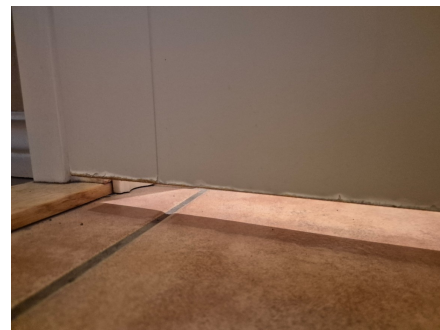
Fuktsveller i bunn av dør.
