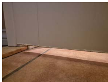
Fuktsveller i bunn av dør.
