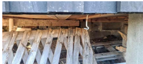
Bjelkelag ytters hvor det er lagret utstyr og materialer.
