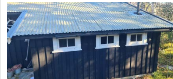
Skade på takrenne utfor inngang.
