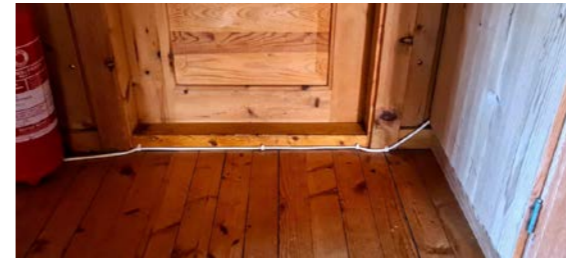
El. ledning ikke utført av el installatør.
