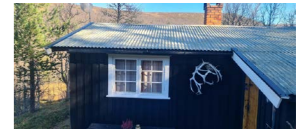
Skade på takrenne utfor stue.
