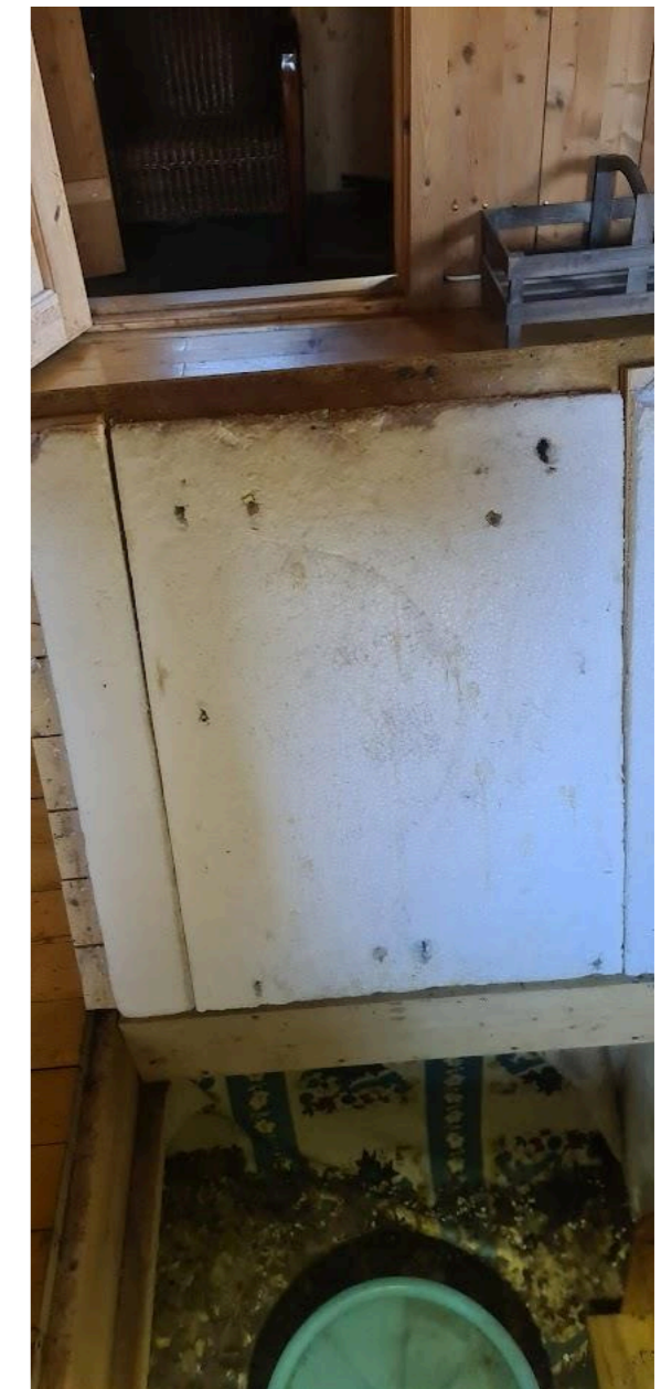
Isopor under kjellerlem i kjøkkengulv.
