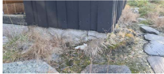
Sprekk og opp smuldring av grunnmur på høyre side av ytterdør.
