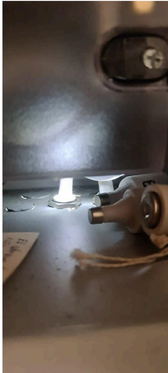
Hull i bunn Sikringskap for kabel innføringer og hull utette.
