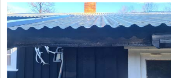
Nærbilde av skade/mangel på takrenne ut for inngang.
