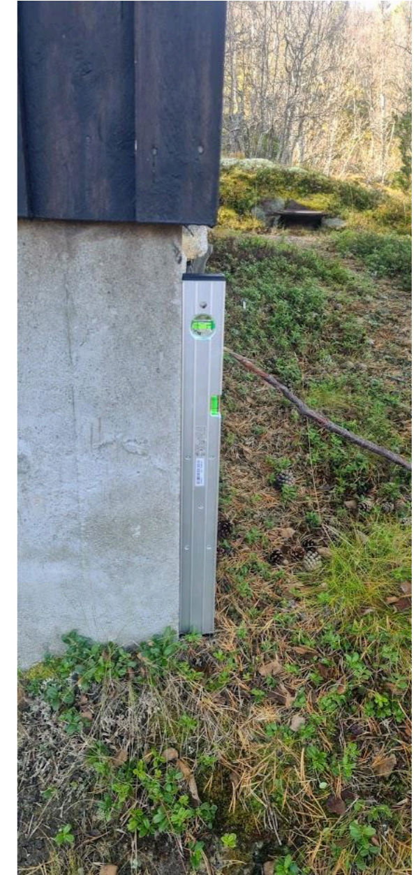
Hjørnepilar er noe ut av lodd.
