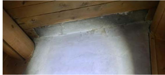
Tegn etter tidligere fuktskader samt riss i puss i pipe over peis i stue.
