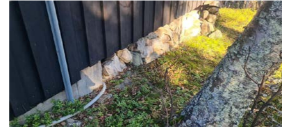
Betongpilarer hvor det er stablet stein mellom. Plastrør er avløp for urin fra biologisk toalett.
