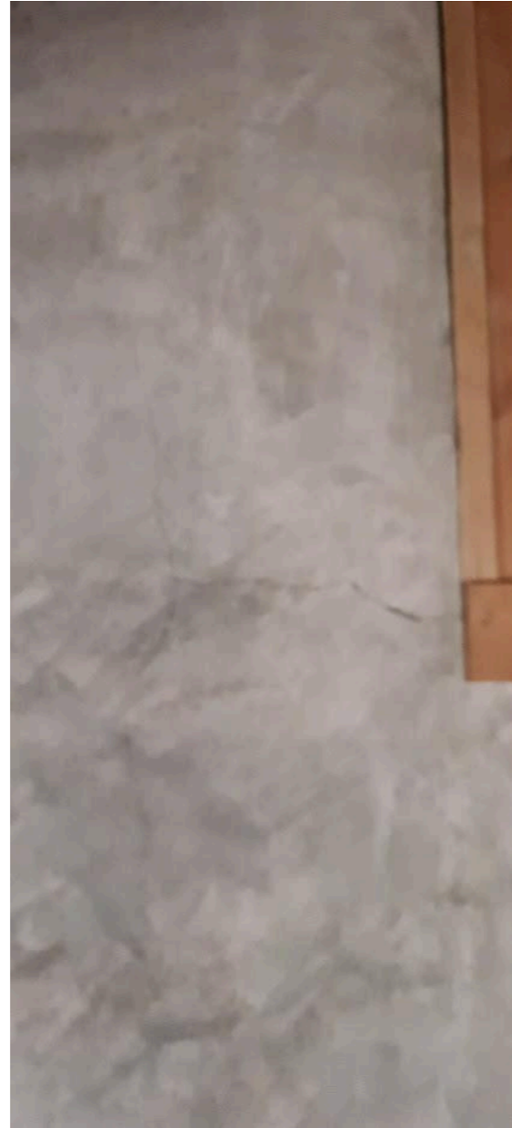
Riss i overflate puss på pipe over peis i stue.
