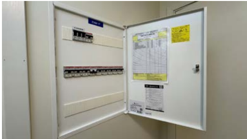
Kontroll av el-skap og kursfortegnelse.
